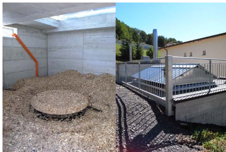
Il serbatoio per il cippato
